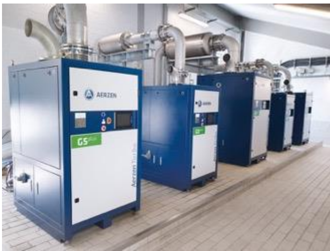
02-AERZEN-Turbogebläse.jpg: Fünf Turbogebläse von AERZEN sorgen für die Sauerstoffversorgung in den Belebungsbecken Bild: AERZEN
