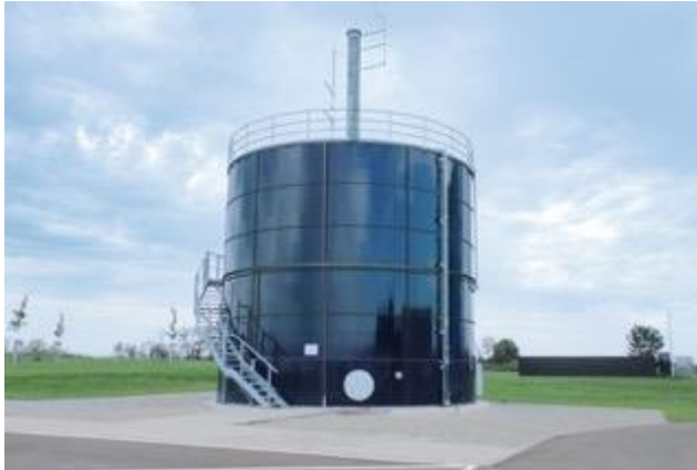
08-AERZEN-Gasspeicher.jpg: Der Gasspeicher hat ein Fassungsvermögen von ca. 500 m 3 Bild: AERZEN
