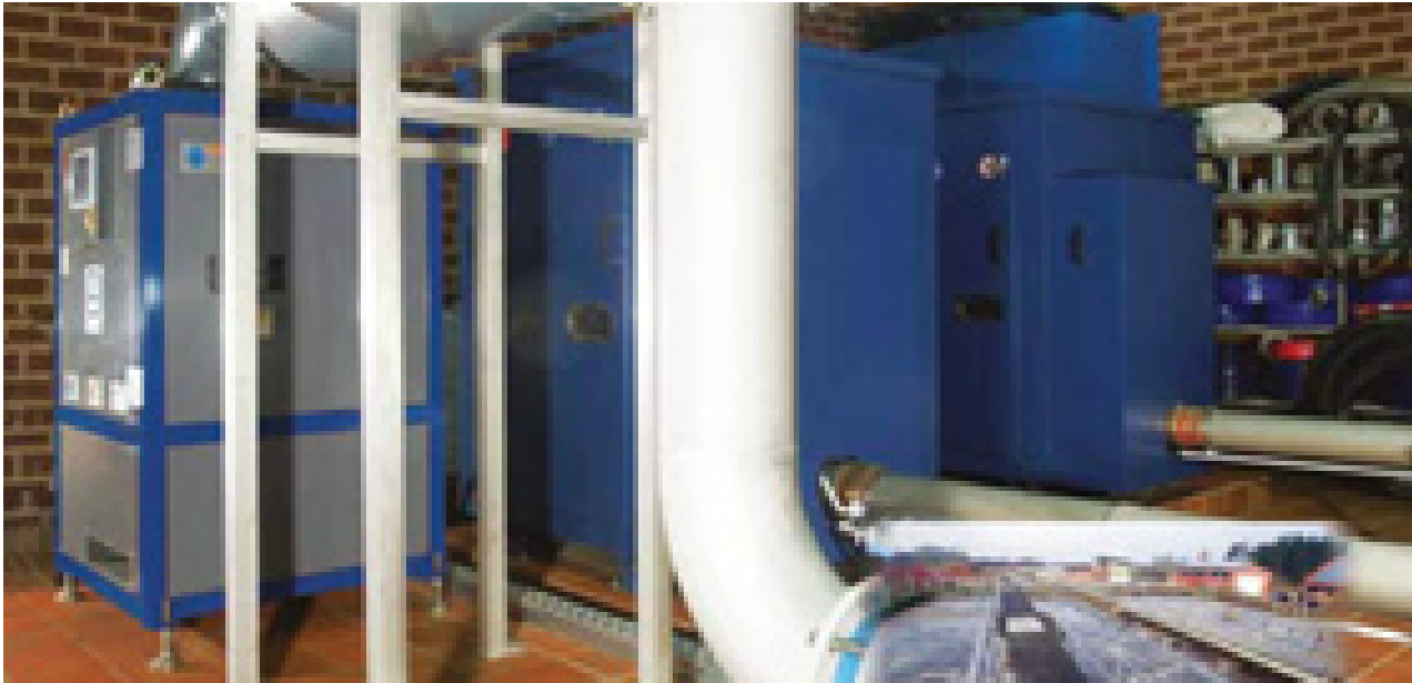
Bild 1 AERZEN AT Turbogebläse und zwei Drehkolbengebläse zur Verarbeitung von Luft bei der Abwasseraufbereitungsanlage in Bremervörde, Deutschland.
