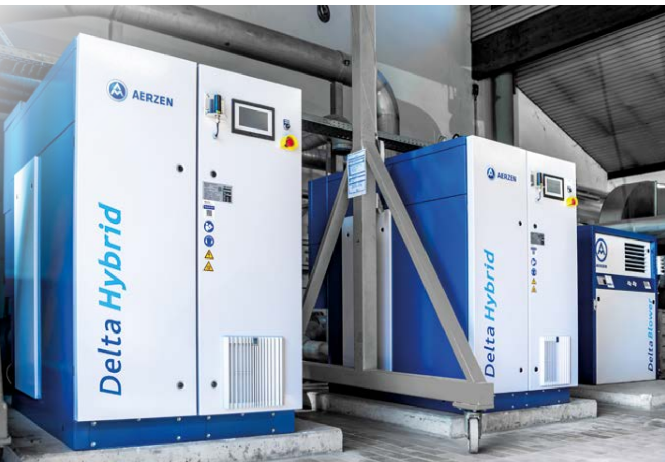
Zwei AERZEN Schraubengebläse vom Typ Delta Hybrid D 31 S mit Direktantrieb sorgen für die Sauerstoffversorgung in den Belebungsbecken. Ein Drehkolbengebläse Delta Blower GM 25 S dient als Redundanzmaschine.
