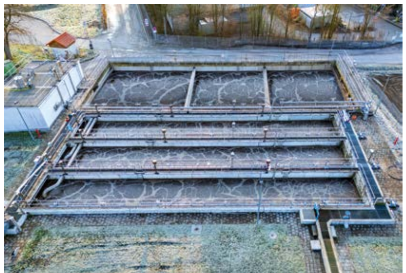
Die biologische Reinigungsstufe umfasst zwei Belebungsbecken. Das erste wird in drei hintereinander geschalteten Kaskaden durchströmt, das zweite ist in drei parallel betriebene Straßen unterteilt.
