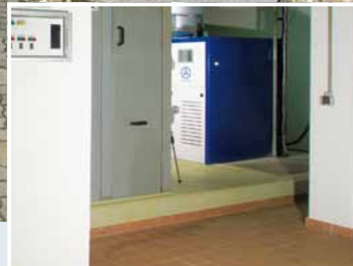
Die Kläranlage Arnsberg-Wildshausen verfügt neben einem Drehkolbengebläse der Baureihe DELTA BLOWER, das Abluft absaugt und in die Belebungsbecken einleitet, auch über ein neues Aerzener Turbo-gebläse in der zentralen Druckluftstation.
