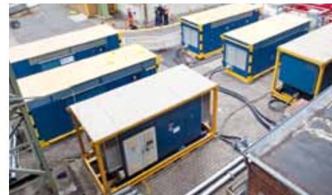
Leihanlage von Aerzen International Rental mit sechs ölfrei verdichtenden AERZEN Schraubenverdichtern zur vorübergehenden Förderluft-Versorgung
