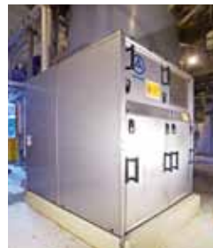
Förderluft-Station der Zellstoff Stendal GmbH mit dem Drehkolbenverdichter der neuen Baureihe Delta Hybrid Generation 5 von AERZEN
