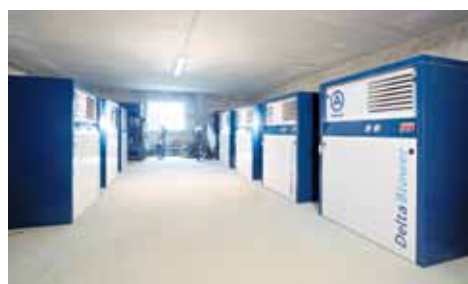
Zentrale Sauerstoff-Station bei Winkelmann mit neun elektrisch und zwei über Dieselmotor angetriebenen Drehkolbengebläsen der Baureihe Delta Blower Generation 5 von AERZEN
