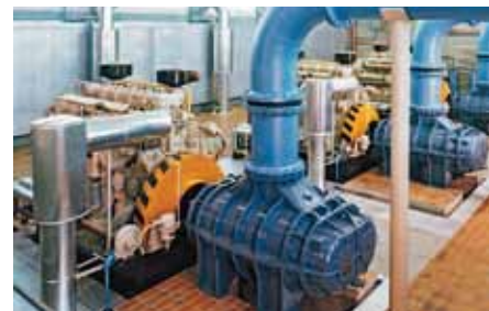
Auch für die Umwelttechnik lieferte AERZEN frühzeitig Komponenten, zum Beispiel Drehkolbengebläse vom Typ GMa 18.17 zur Belüftung von Klärbecken.
